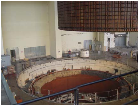
Рис. 3. Смещение ротора в сторону нижнего бьефа
